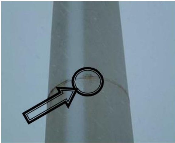
Ρωγμή σε συγκόλληση του πυλώνα
