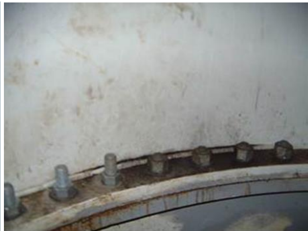
Ρωγμή σε συγκόλληση φλάντζας στον πυλώνα
